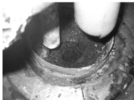
写真5 ホッパーの錆
